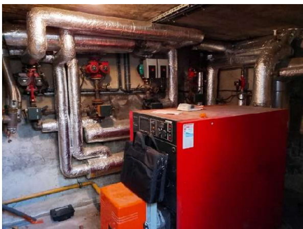
Chaudière au sol et distribution calorifugée avec panoplie
