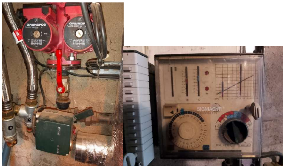
Départ avec vanne 3 voies (gauche) et régulateur mécanique (droite)
