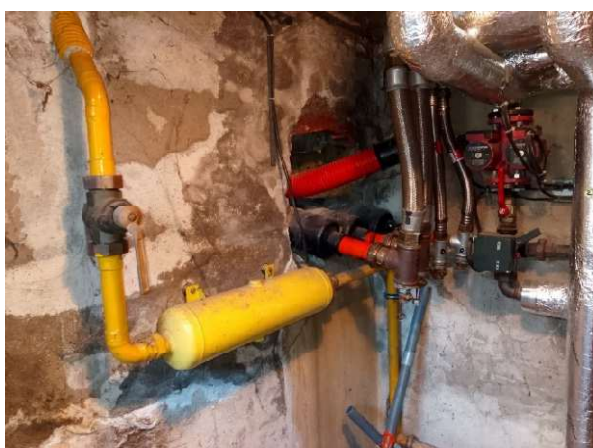
Départs secondaires vers réseaux enterrés
