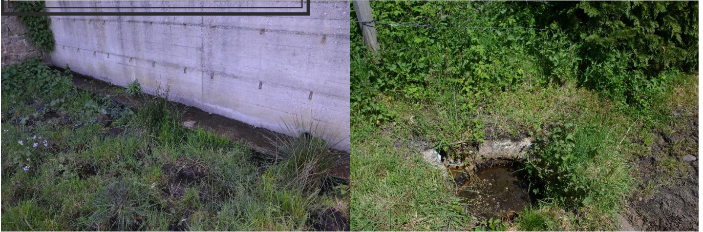
Parcelle AE 139 haut en contre bas de la route : arrivées de la source contre le bâti (photos Luc Laurent)
