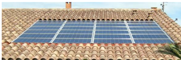
Panneaux encastrés à la pente du toit
